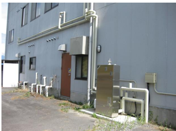
冷温水熱交換システム
